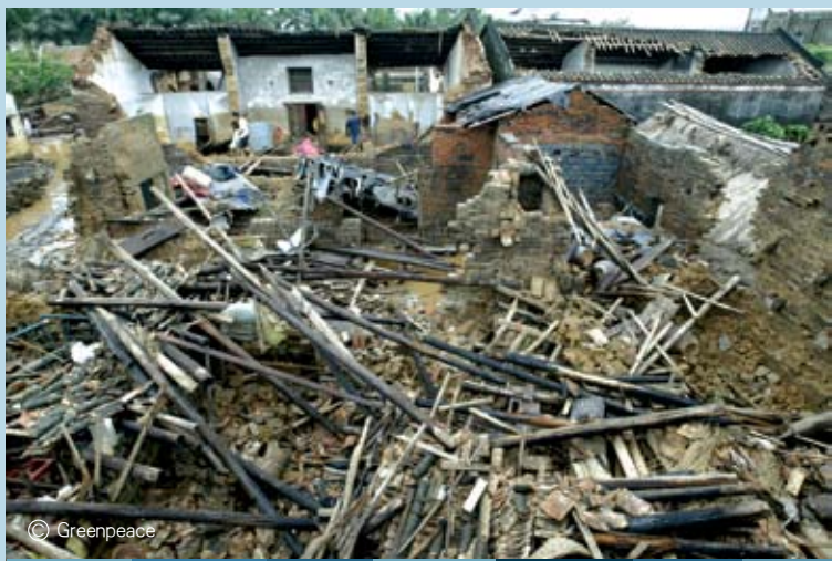
广东雷州台风后，2007 After typhoon, Guangdong, 2007
